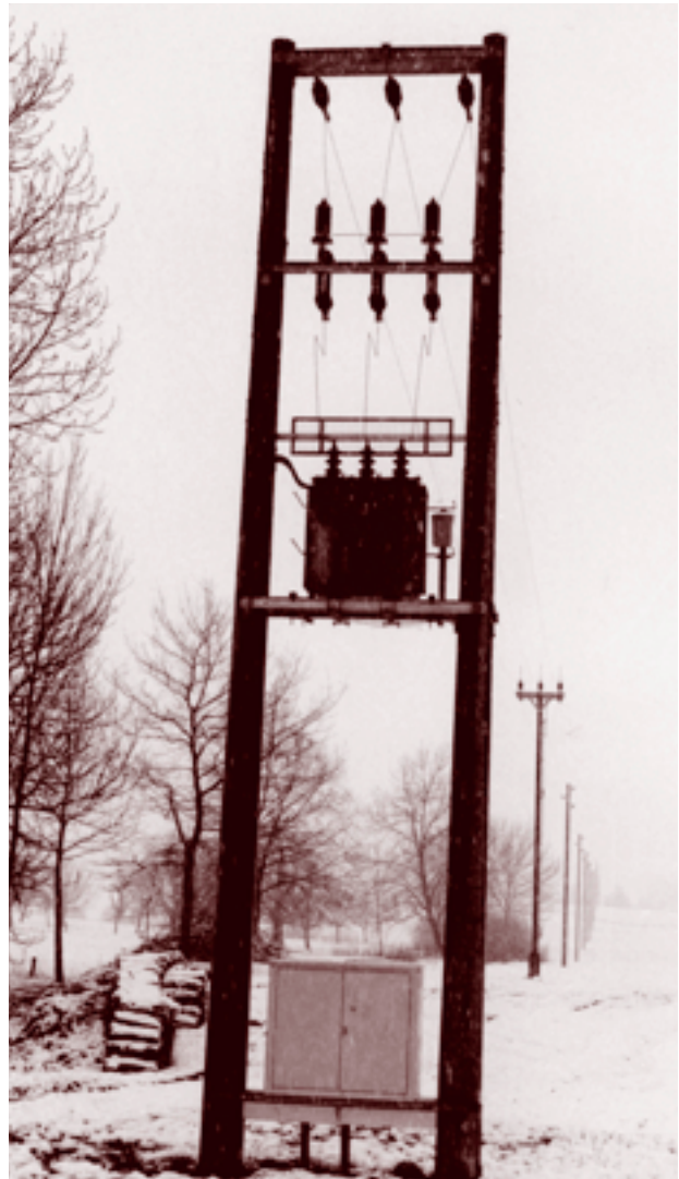
Heute eine der letzten EWM Freileitungen: Stangentransformator im Anet
